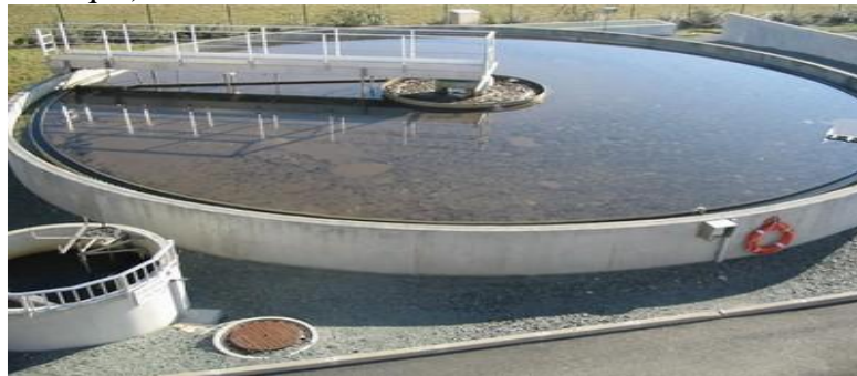
- Bassin de décantation
