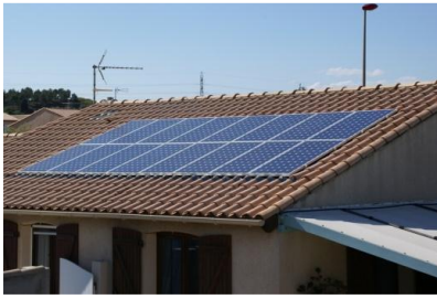
Panneaux photovoltaïques en toiture de maison
