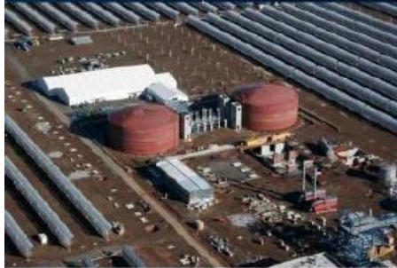
Cuves de stockage thermique
