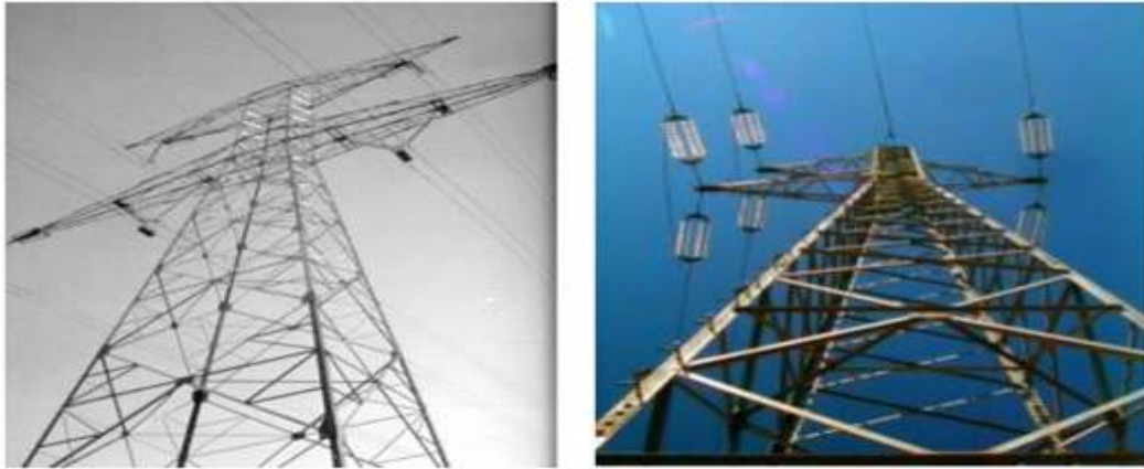
Figure 12: Photo de pylônes en acier .
