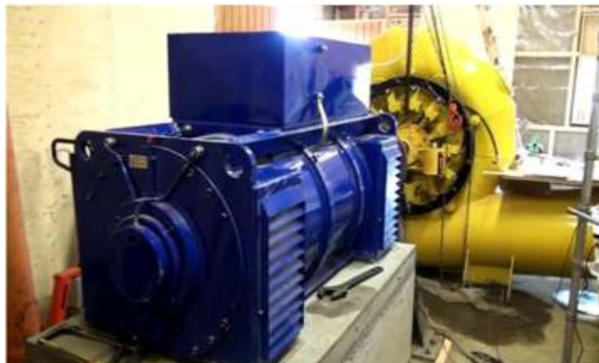
Figure 11 : Photo d'une génératrice .
