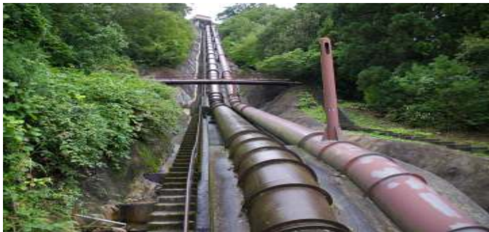
Figure 7 : Photo de conduites d'eau .
