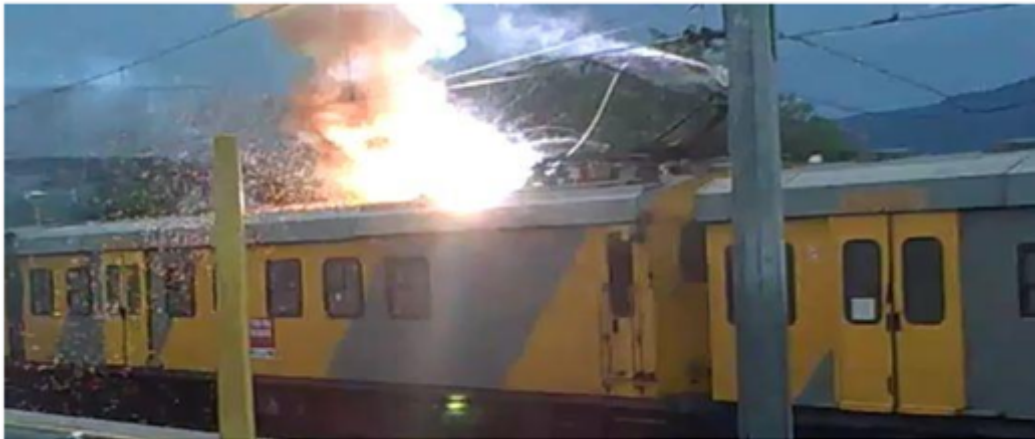
Explosion d'origine électrique
