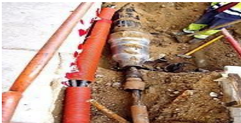
Canalisation à remplacer au niveau d'une fouille ou d'un regard
