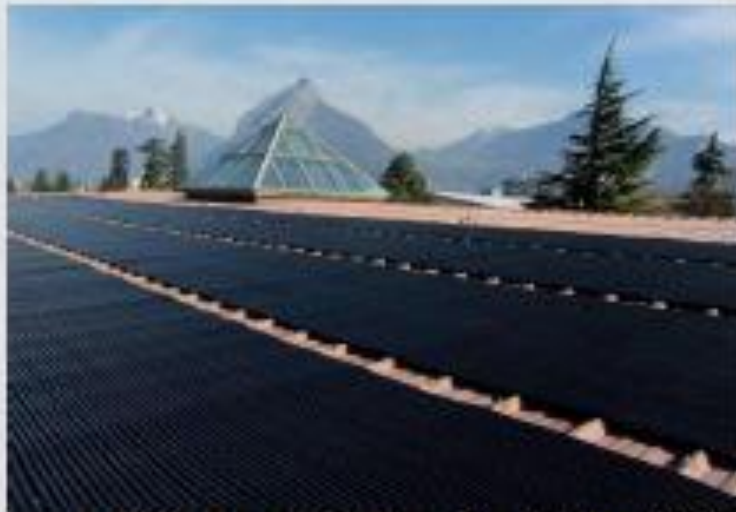
Capteurs non vitrés sur un toit de piscine (photo : héliopac)
