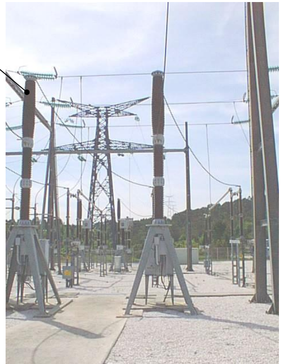
---- disjoncteur 63 kV au SF6 ----
