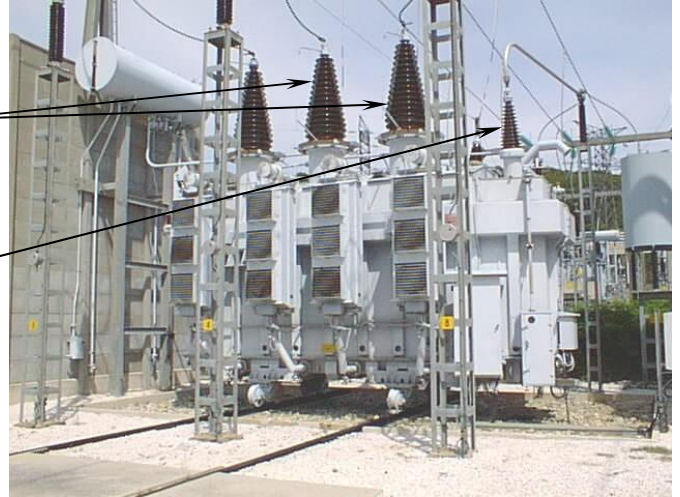
--- Transformateur 225/63 kV immergé dans l'huile ---
