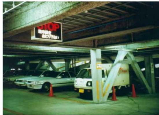
Diagonales en béton armé
