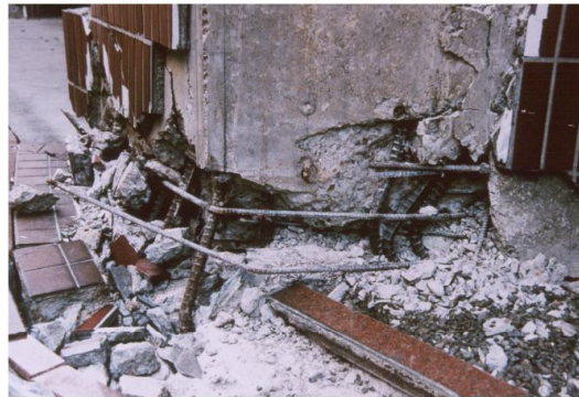
Rotule plastique en pied de poteau en BA
