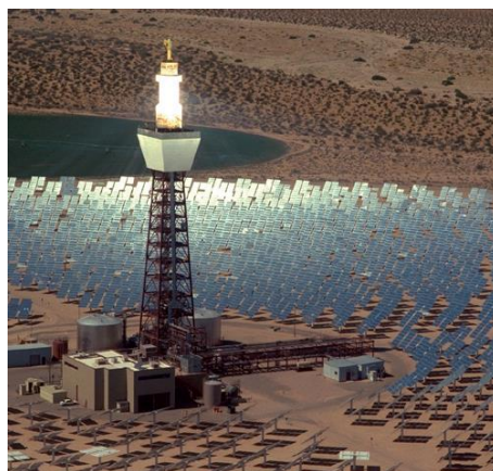
Récepteur à cavité d'une tour solaire
