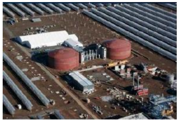
Cuves de stockage thermique
