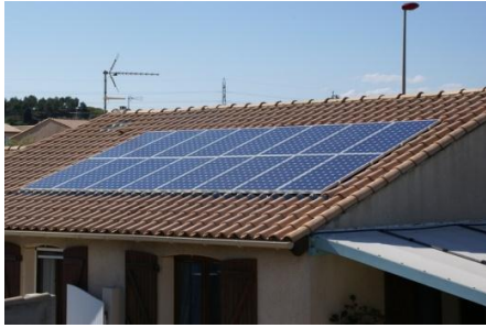
Panneaux photovoltaïques en toiture de maison
