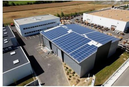
Panneaux photovoltaïques en toiture d'entrepôt
