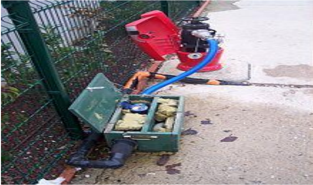
Figure 41 : Compteur provisoire raccordé à une borne d'incendie pour alimenter un chantier de construction
