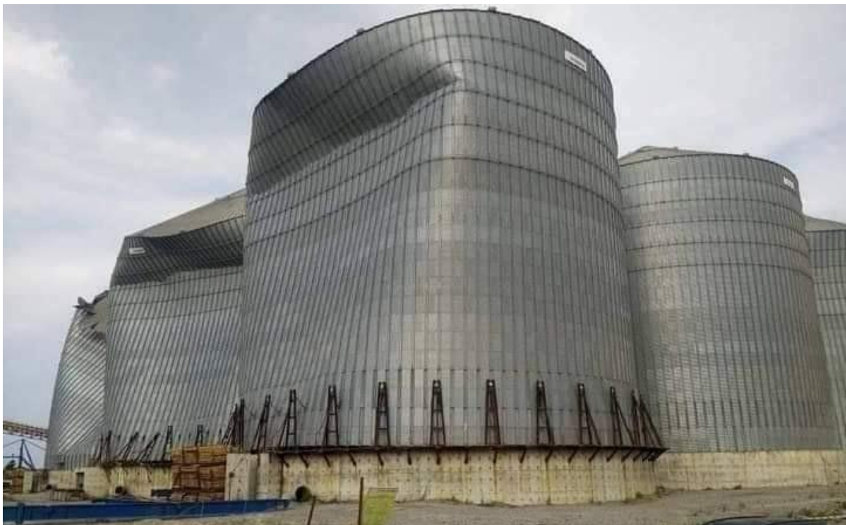
Flambement des viroles supérieures de plusieurs silos de soja. (Port de DjenDjen, Jijel, Algerie) Septembre 2020.
